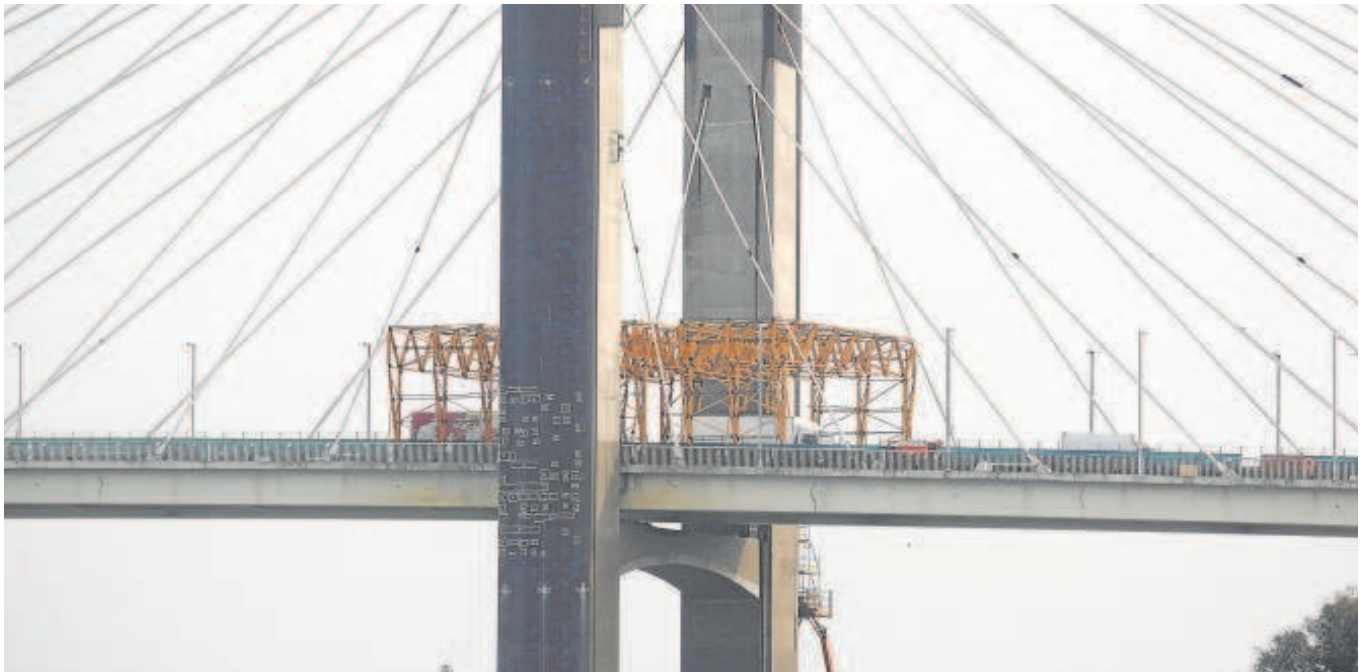
Andamios instalados en la parte central del puente del Centenario para su ampliación y la sustitución de los tirantes // J. M. SERRANO
