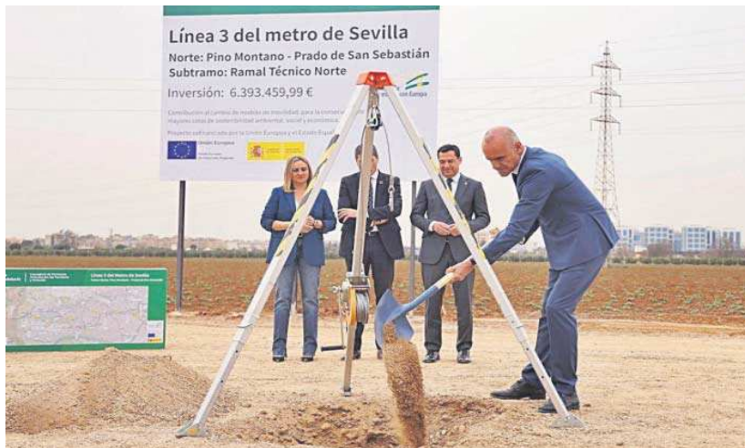
Antonio Muñoz da una palada durante el acto inaugural de las obras en el ramal técnico de la línea 3. ANTONIO PIZARRO
