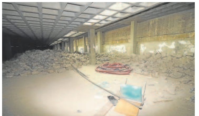
Arriba, el edificio desocupado del Paseo Marqués de Contadero, cubierto por una chapa y en cuyo interior –como se observa en la imagen superior– hay almacenados escombros desde hace seis años. A la derecha, el transformador que hay a su espalda, habitado por mendigos // FOTOS: JUAN FLORES / ABC
