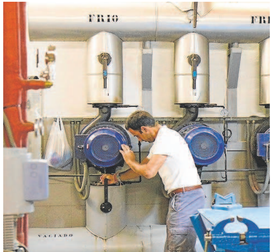
Instalaciones de aire en el Virgen del Rocío // ABC
