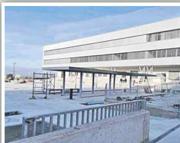
Maracena (Granada) La obra ya finalizada del nuevo instituto en Maracena, pendiente de recepción, se ha ejecutado con una inversión de 4.697.336 euros.
