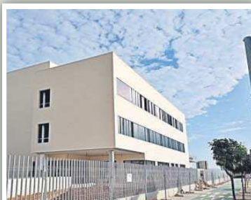
La Rinconada (Sevilla) La obra del Centro Integrado de Formación Profesional de Referencia Aeroespacial, a punto de terminar, ha contado con 12.285.502 euros.
