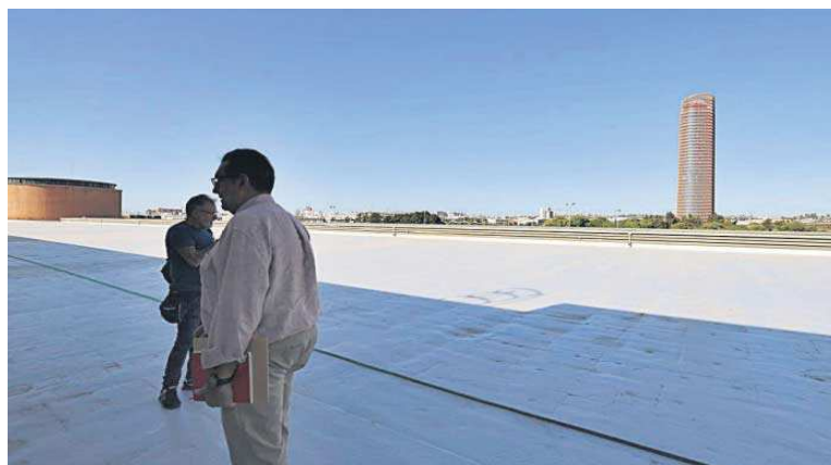
La cubierta se ha impermeabilizado con una pintura de color gris claro que reduce el calentamiento.
