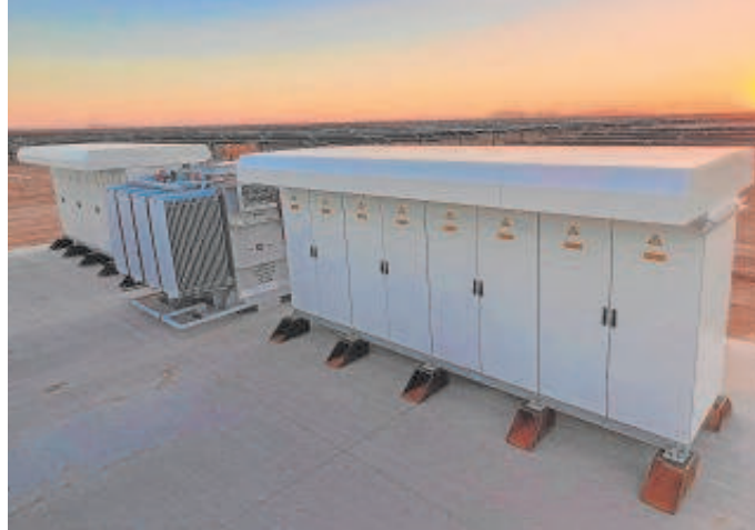
Dispositivos de la firma sevillana para almacenar energía // ABC
