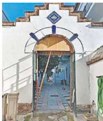
Otras fisuras en el recinto.
