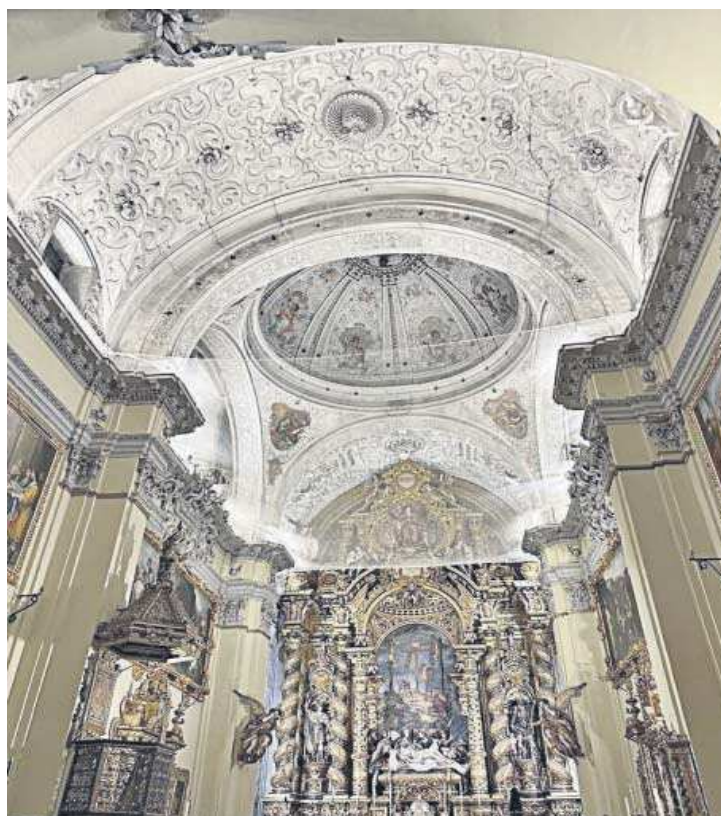
Grietas en las bóvedas de la iglesia del Hospital de la Caridad.
