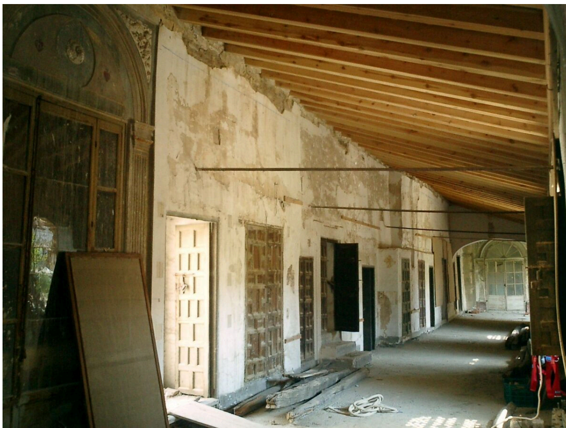
Partes de Santa Clara sin rehabilitar. / M. G.
