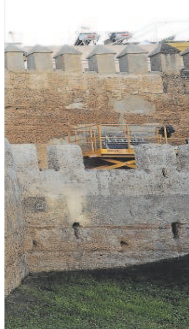
La barbacana y el lienzo de muralla extramuros de la Macarena, una vez que han concluido los trabajos de rehabilitación de este tramo
