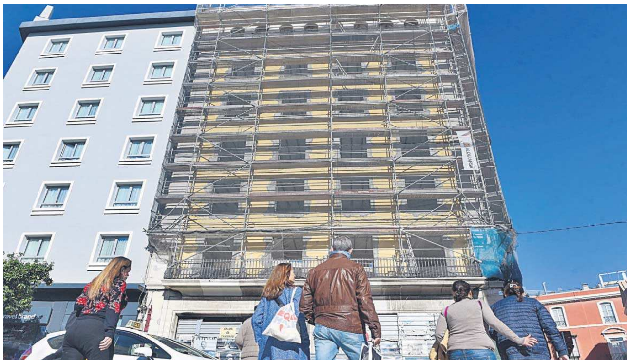
El edificio de los antiguos sindicatos donde se ejecuta la obra de rehabilitación para un nuevo hotel.
