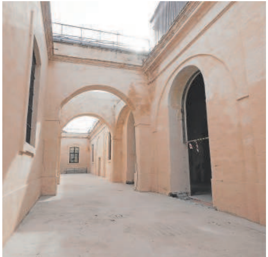
Las obras de rehabilitación de Artillería se pararon en septiembre // MANUEL GÓMEZ
