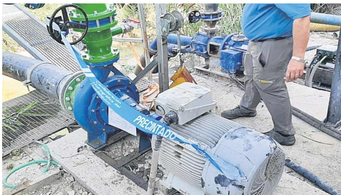
Tomas de agua ilegales para el riego en el río Guadajoz en una finca de la provincia de Córdoba.
