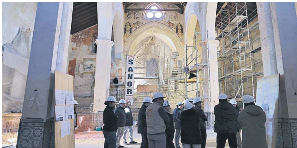
Vista general de la iglesia en plena restauración con su singular presbiterio elevado al fondo.
