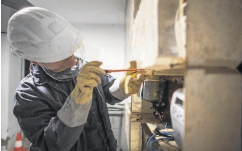
Un técnico de Endesa trabaja sobre los contadores de unas viviendas en Sevilla // ABC
