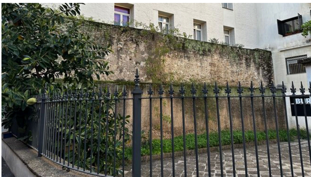
Comida por jaramagos: este es el deplorable estado de un lienzo da muralla islámica de Sevilla. / D. S.
