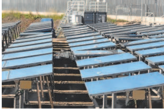
Placas fotovoltaicas para producir energía // EP
