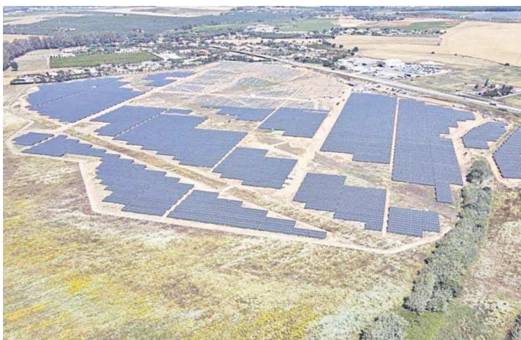
Planta solar de San Antonio de Endesa en Huelva.
