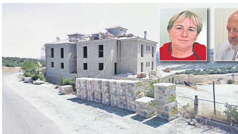
Una imagen del hotel en plena construcción, pegado a la carretera. Arriba, Virtudes Cabello y José Antonio Mañas.
