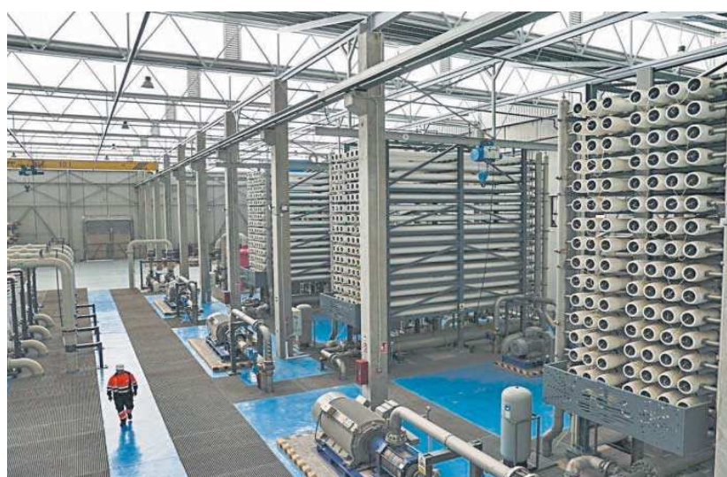
Instalaciones de la desaladora de Sagunto que abastecerá de agua a Barcelona.
