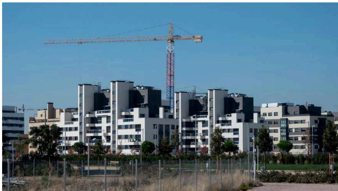
Una grúa en una zona de construcción de edificios. / Alberto Ortega - Europa Press
