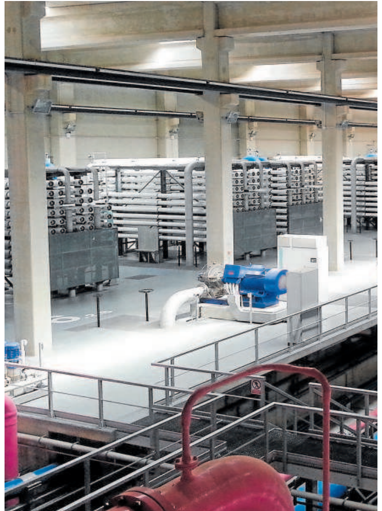
Desaladora de Águilas, en Murcia // ABC
