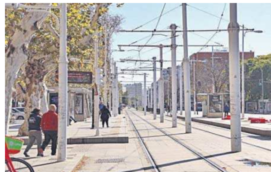
Postes de catenaria del tranvía en la zona del Prado.
