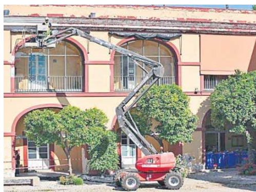
Un operario, con la ayuda de una grúa, actúa sobre unos frisos en mal estado.
