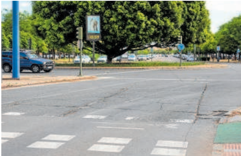
Estado del pavimento de un tramo de la Ronda del Tamarguillo/ ABC
