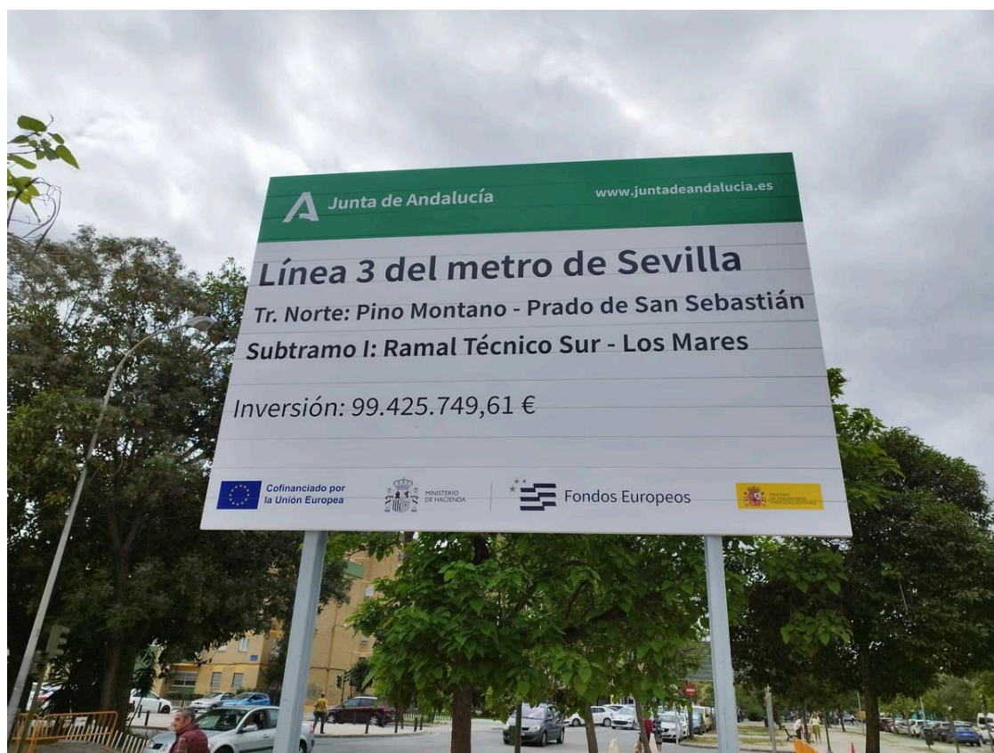
Comienzan las obras del primer tramo de la línea 3 del metro de Sevilla
