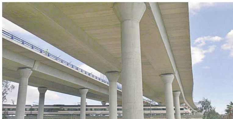
Una de las estructuras elevadas de la SE-40.
