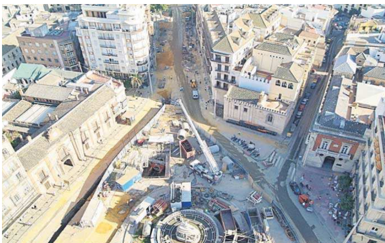
El pozo abierto en la Puerta de Jerez para renovar las canalizaciones de Emasesa,
