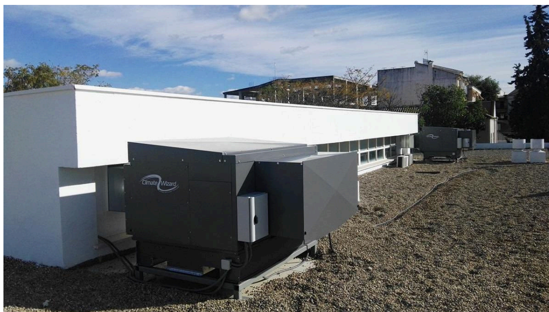
Sistema de refrigeración adiabática en el CEIP José Antonio Valenzuela (Córdoba)
